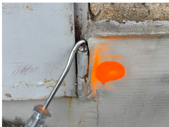
Obr. 32 Defekt D1 detail
